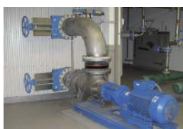
Pompe à impulsion
